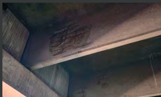
VIGA DE CONCRETO DAÑADA.
